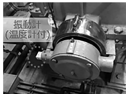
那珂配水ポンプ2号(軸受部)
