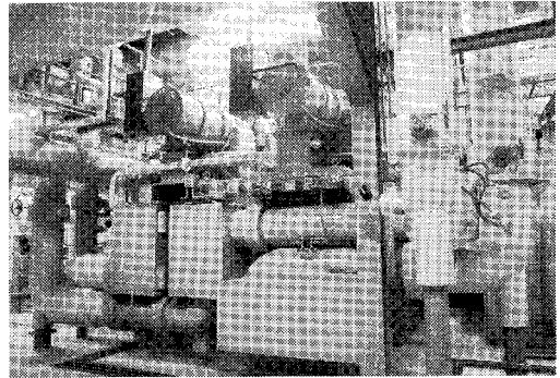
写真2 後楽地区熱供給事業用ヒートポンプ
