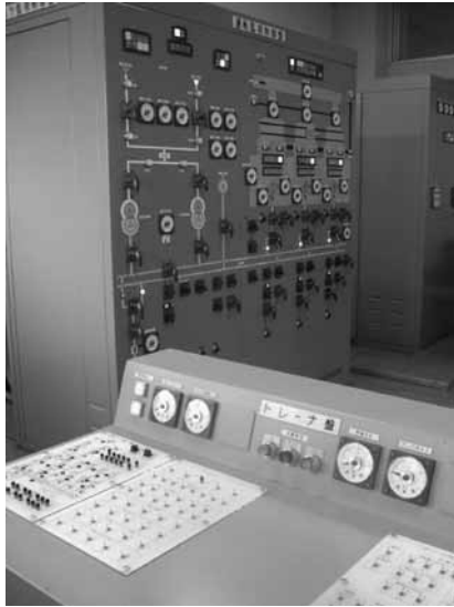
Fig.2 雨水ポンプ所模擬プラント運転監視制御盤
