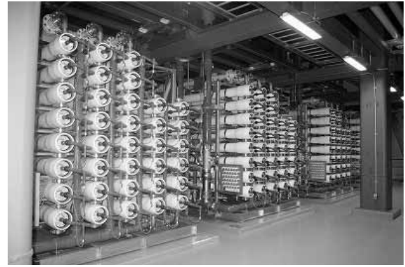
Photo. 2 RO ユニット
