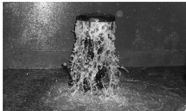
Photo 1 空気弁からの漏水の様子
