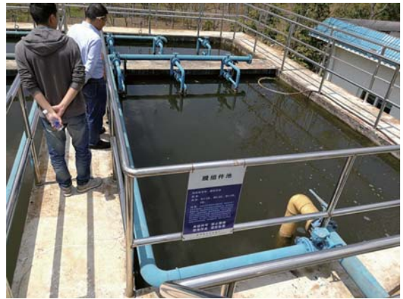
写真2 昆明市滇源鎮汚水処理場（膜モジュールが撤去された膜分離槽、2018年3月筆者撮影）
